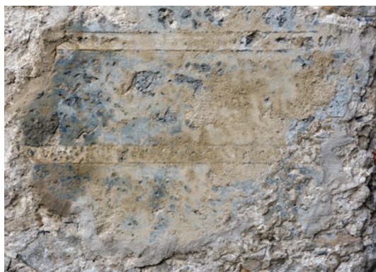
9. Pawilon wejściowy papierni, przyziemie po skuciu współczesnych tynków z widoczną pierwotną dekoracją. Fot. R. Gliński (góra) i M. Mackiewicz (dół)
