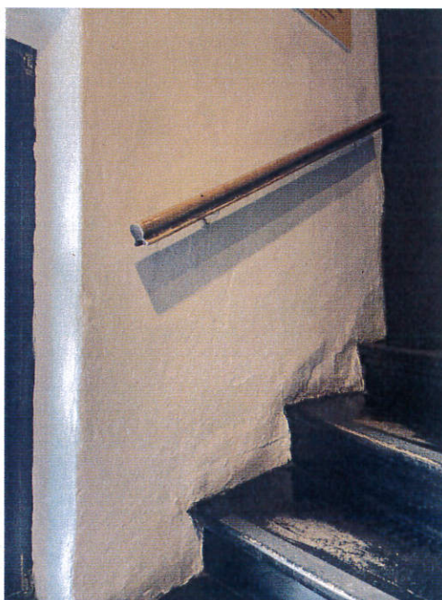
- fragment klatki schodowej, widoczny stan zachowania stopnic i wtórną (niewłaściwą) poręcz,
