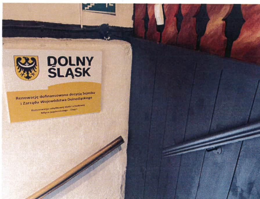
- fragmenty klatki schodowej ilustrujący konieczność założenia właściwej poręczy,
